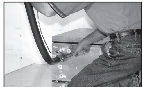
Conexión al lado de la Sección evaporadora
